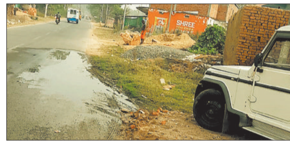
सड़क पर बह रहा घरो का पानी।
